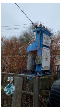
Рисунок 4 – Трансформаторная подстанция 10/0,4 кВ в с. Кокино
